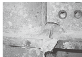
(a) 被災した梁部材
